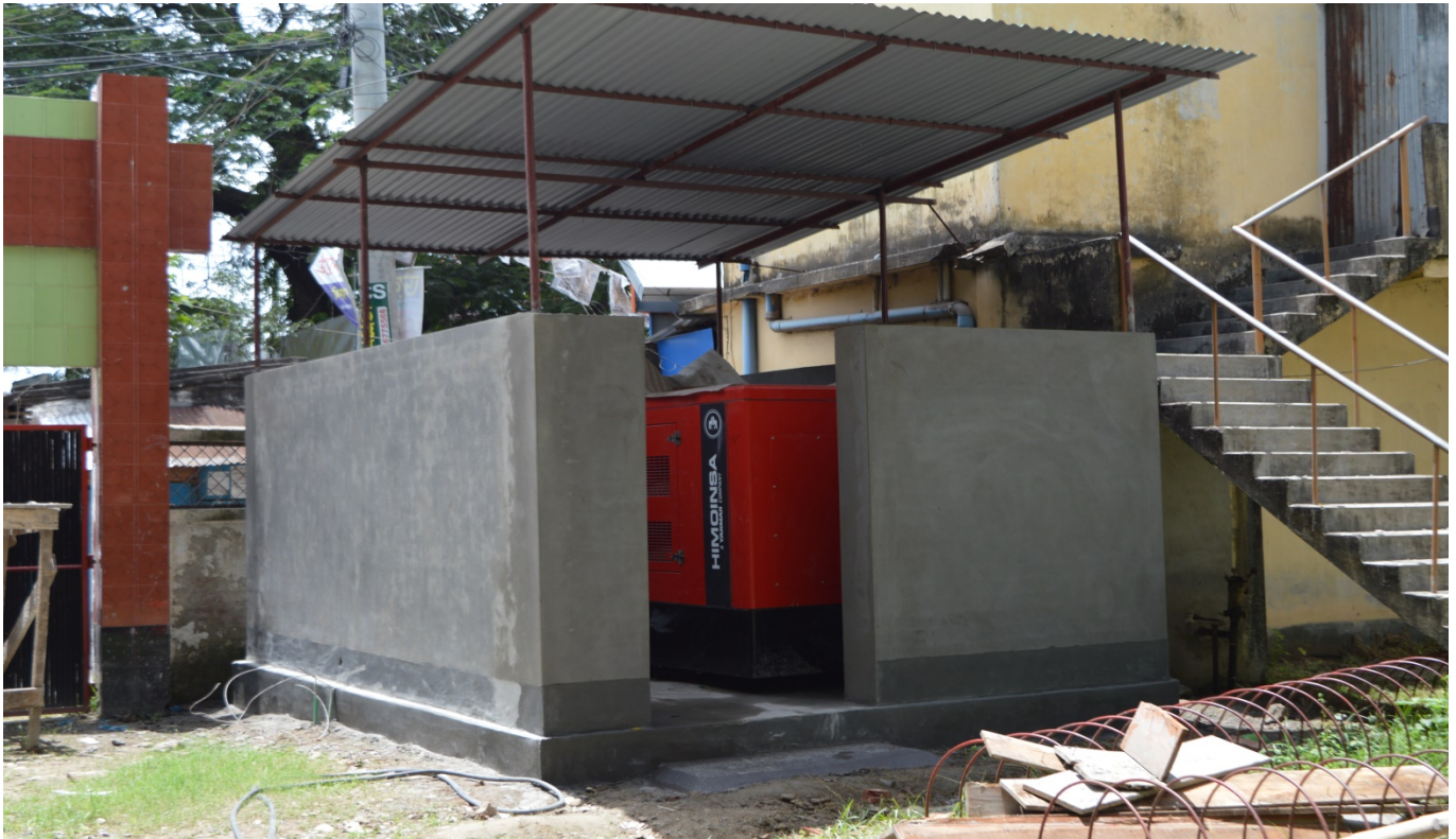
250 KVA Diesel Generator
